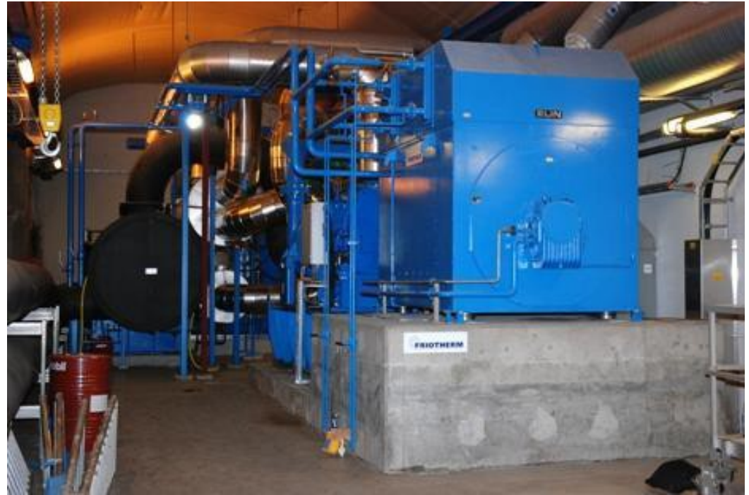
Abwasser-Wärmepumpe Friotherm Fernwärmeversorgung Oslo Quelle: www.vvsforum.no
