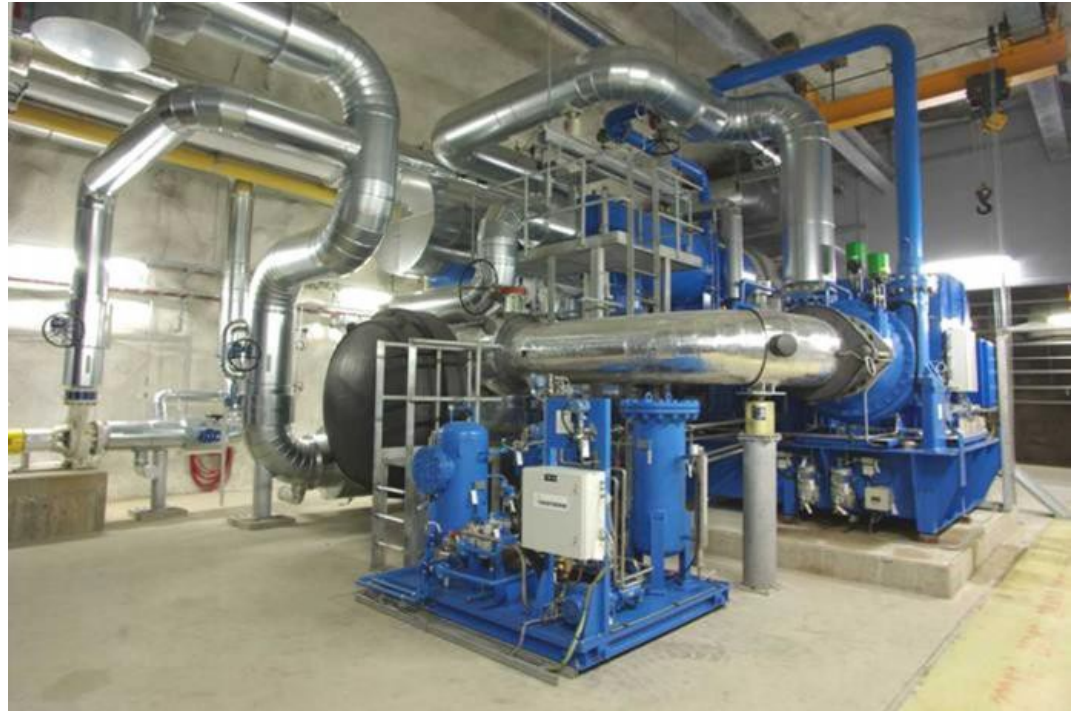
Meerwasser-Wärmepumpe Fernwärmeversorgung Helsinki Quelle: www.friotherm.de
