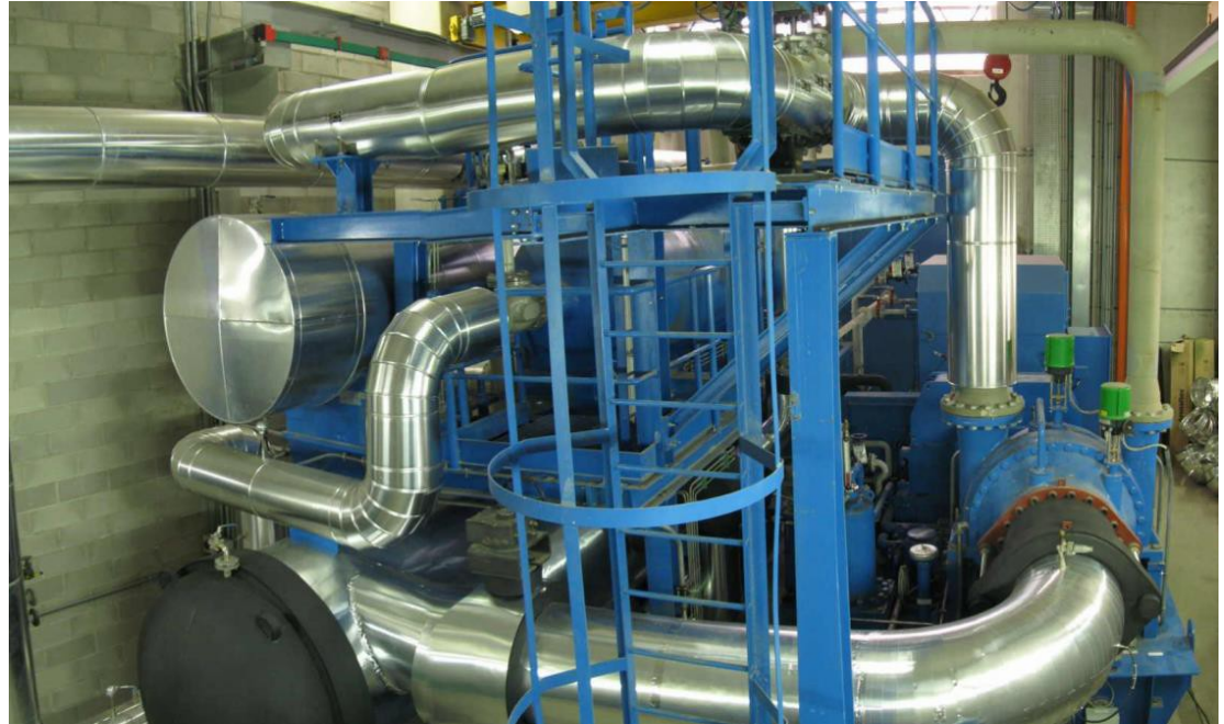
Trinkwasser-Großwärmepumpe Canavese Mailand Quelle: Masella
